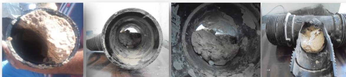
شکل ۲ - تصویرهایی از گرفتگی لوله‌های اصلی آبرسانی متأثر از کیفیت آب
